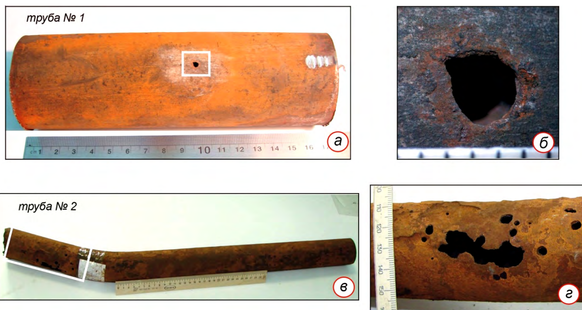
Рис. 1. Общий вид предоставленных на исследование фрагментов труб и увеличенные изображения эксплуатационных повреждений в них: труба № 1 (а) со свищом (б); труба № 2 (в) со скоплениями свищей (з)
